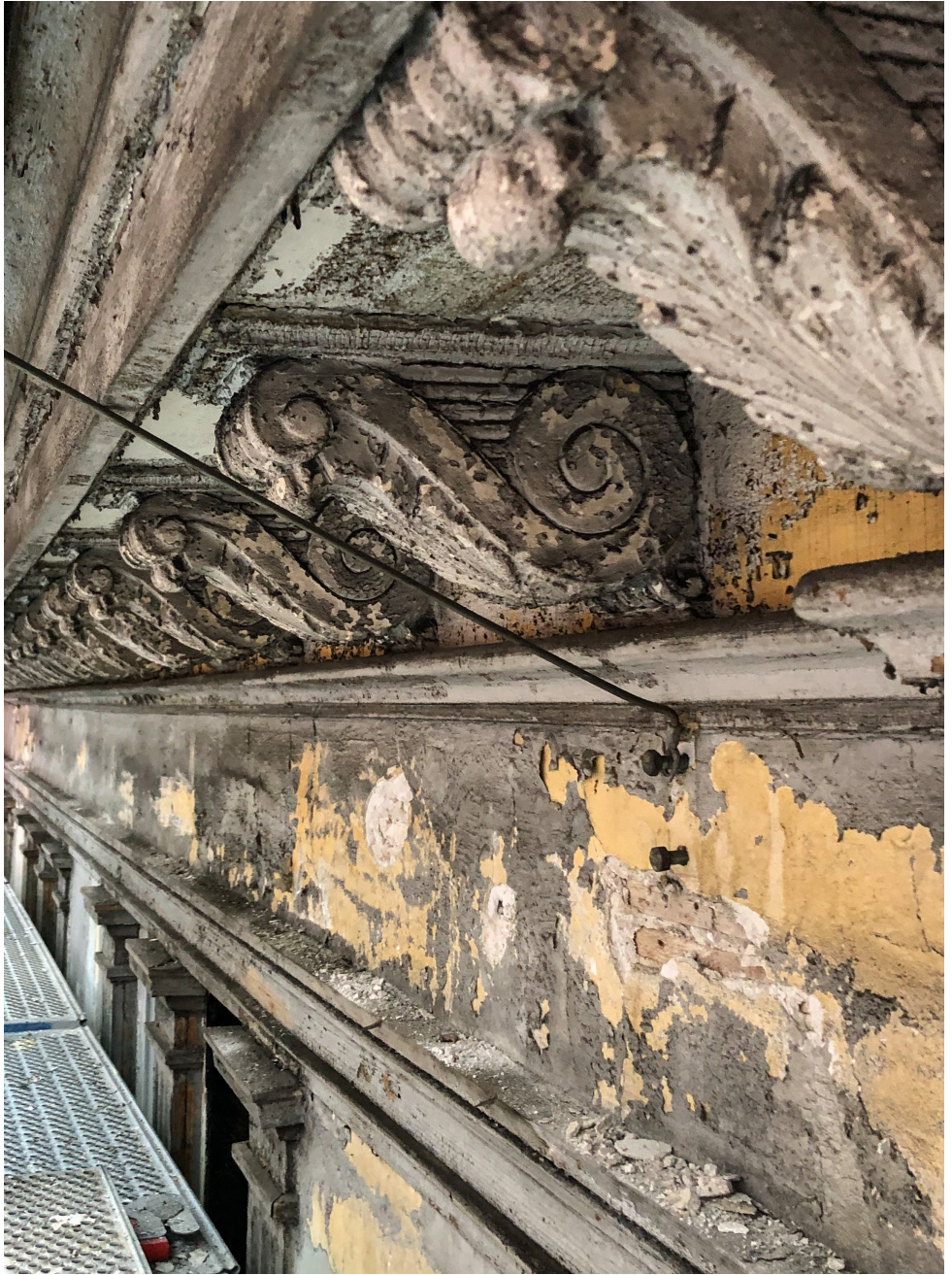
Stark verwitterte Untersicht mit Gipskonsolen.
