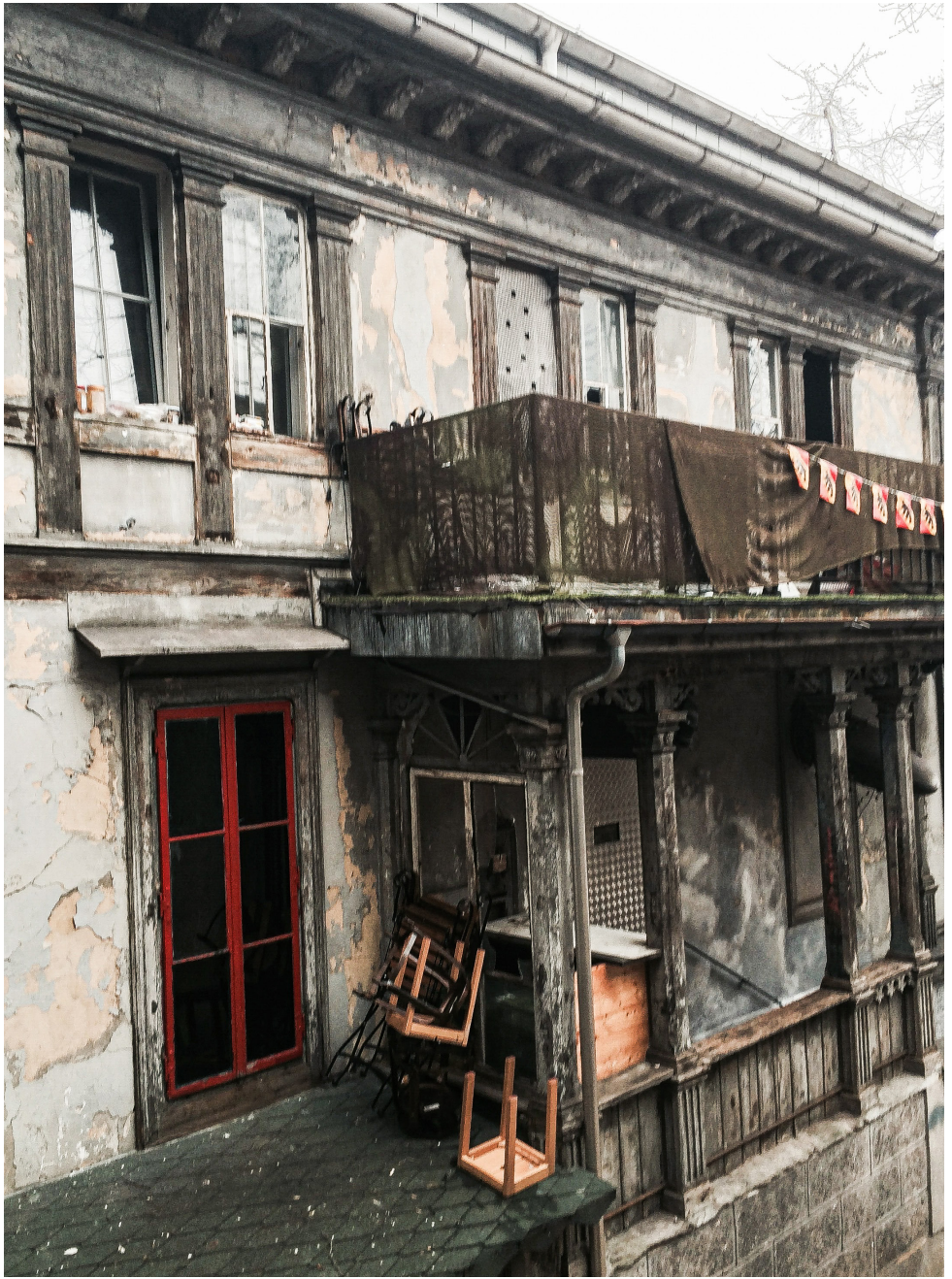
Westseite mit Balkon. Sämtliche Bauteile sind sehr stark verwittert.
